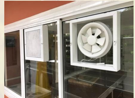
พัดลมระบายอากาศ
