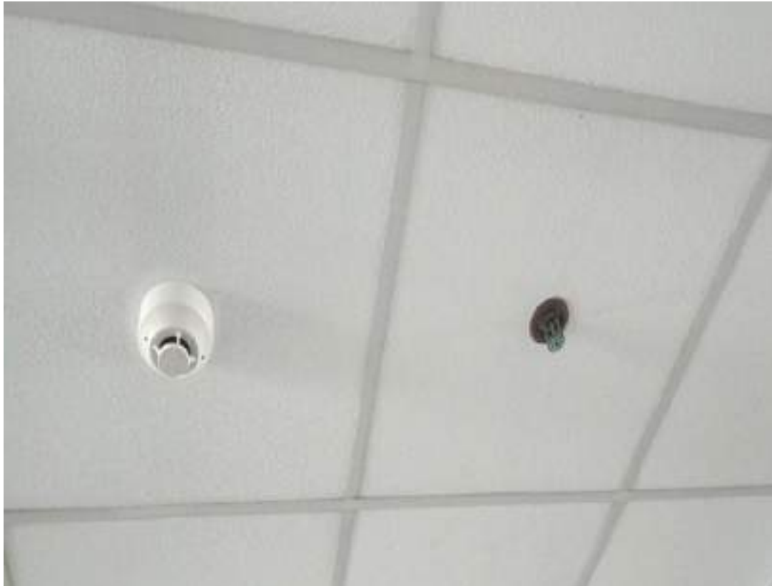
อุปกรณ์ตรวจจับควัน และระบบหัวกระจายน้ำดับเพลิงอัตโนมัติ ที่สามารถระงับเพลิงไหม้ได้ครอบคลุมทั้งอาคาร
