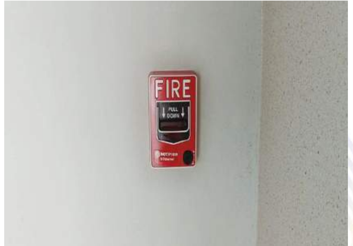
ระบบแจ้งเหตุเพลิงไหม้ด้วยมือ
