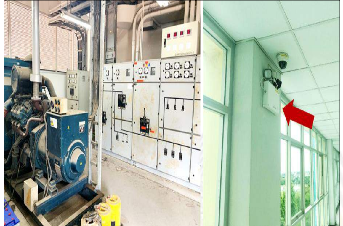
เครื่องกำเนิดไฟฟ้าสำรองฉุกเฉินและระบบควบคุม (ซ้าย) และไฟแสงสว่างฉุกเฉิน (ขวา)
