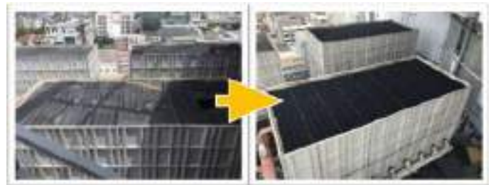
รูปที่ 5 แสดงการเปลี่ยนแผงกันละอองน้ำ (SPECIAL ELIMINATOR)
