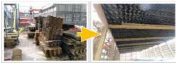
รูปที่ 2 แสดงการเปลี่ยนแผ่นขยายฟิล์มน้ำ (PVC.FILLING)
