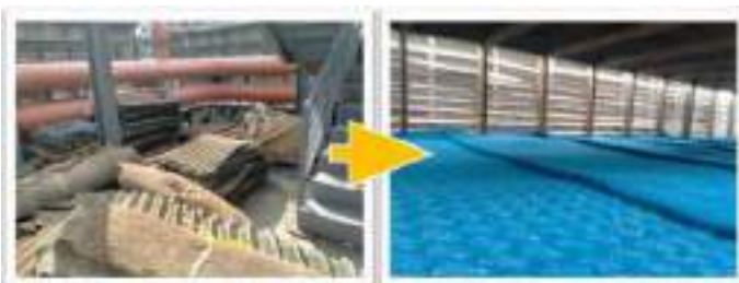
รูปที่ 4 แสดงการเปลี่ยนแผ่นซับแรงกระแทกของน้ำ (SPLASH MAT)
