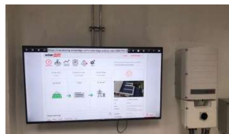
รูปที่ 1 ภาพตำแหน่งติดตั้งหน้าจอแสดงผล ณ อาคารสำนักงานระบบบำบัดน้ำเสียรวม มหาวิทยาลัยมหิดล ศาลายา
