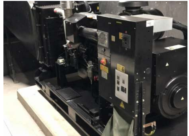
รูปที่ 4 เครื่องกำเนิดไฟฟ้าของอาคารสิริวิทยา
