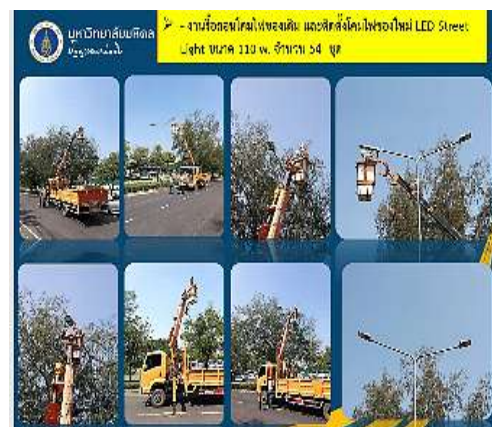
รูปที่ 9 โครงการปรับปรุงไฟฟ้าและแสงสว่างถนน
