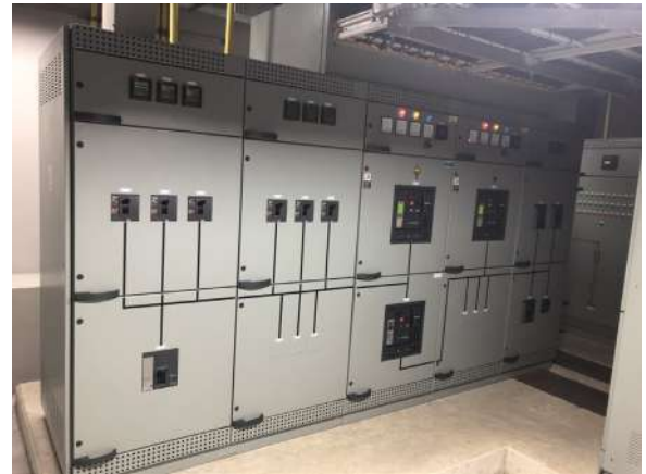
รูปที่ 3 ตู้ควบคุมไฟฟ้าของอาคารสิริวิทยา
