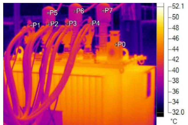
รูปที่ 9 ภาพถ่ายความร้อนของหม้อแปลงไฟฟ้าอาคารโรงสูบน้ำประปา ขนาด 500 kVA การติดตั้งแบบตั้งพื้น
