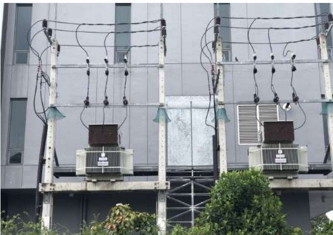
รูปที่ 2 หม้อแปลงไฟฟ้า อาคารสิริวิทยา
